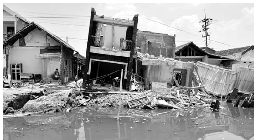
TERGENANG AIR: Aliran air mulai menggenangi proyek box culvert di sekitar rumah Karang Poh gang II yang miring akibat tanah lengser, setelah diguyur hujan cukup lebat dua hari yang lalu.
